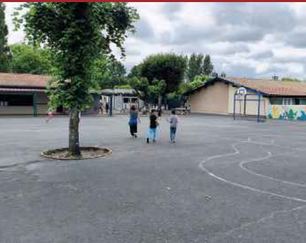
La cour des élèves de section élémentaire a besoin d'être rénovée, notamment en raison des dégradations causées par les arbres.
